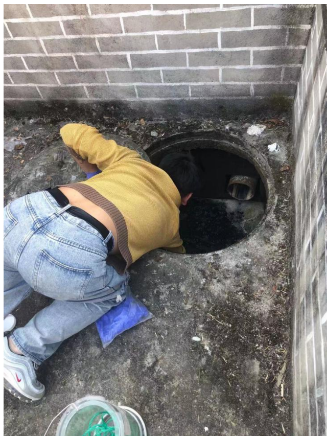
废水进口采样点
