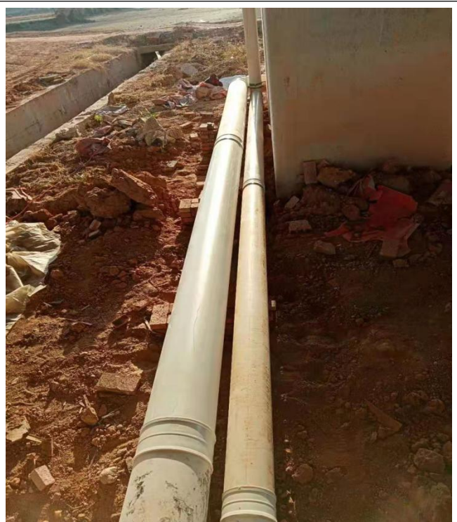
南岸应急池引水管
