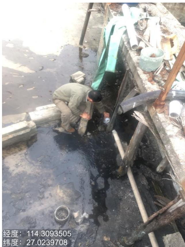
综合废水进口
