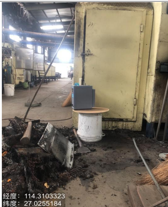
喷涂废气进口
