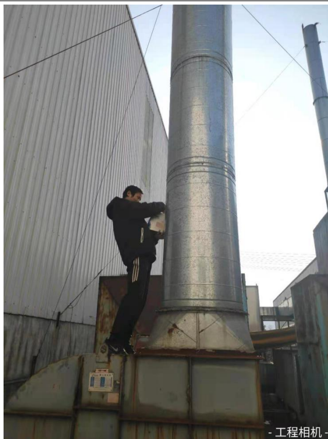
喷涂废气2#出口
