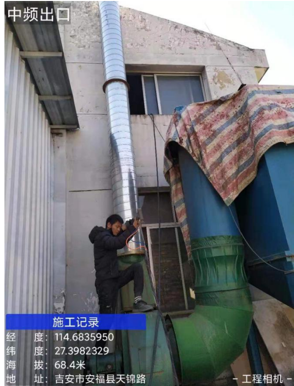
中频炉废气出口
